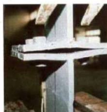
Figure 9 : Déformation de la platine et destruction des boulons.
