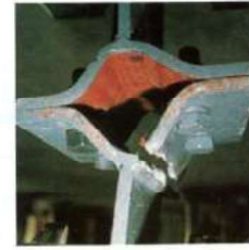
Figure 8 : Rupture totale de la platine d'extrémité, les boulons restent intacts.
