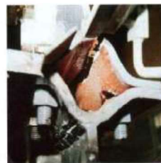
Figure 7 : Platine ruinée au droit de la semelle tendue et traversée par les boulons.
